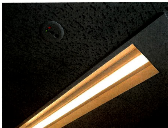
市役所通路に設置されたスマートファシリティ(センサーと灯具)
