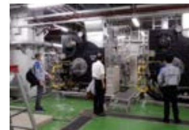
県有施設のエネルギーシフト （派遣元企業による調査）
