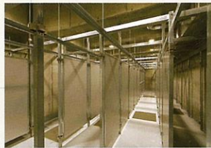
迷路避難室 ・可動間仕切りによる迷路避難訓練が可能
