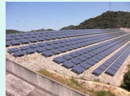
権現ダムメガソーラー
