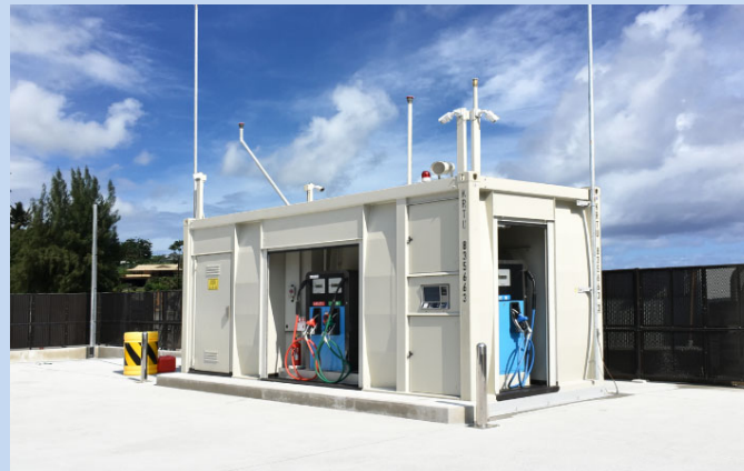
過疎地でのコンテナ式給油所(地上タンク)の活用に向けた実証実験(コモタ株式会社)
