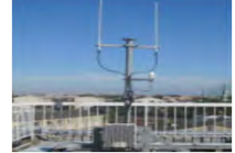
通信施設の整備
