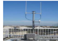
通信施設の整備
