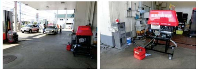
平成30年北海道胆振東部地震の際に自家発電設備を稼働させて給油を続けるSS
