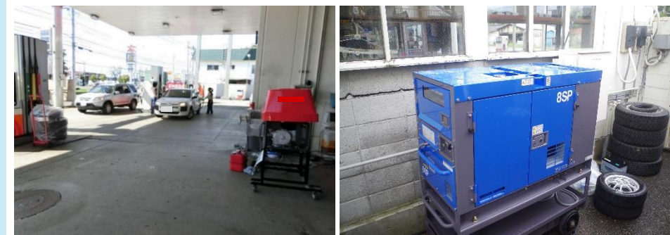
平成30年北海道胆振東部地震や令和元年台風第15号の際に自家発電設備を稼働させて給油を続けたSS
