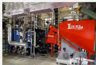
もみ殻バイオマスボイラー 出所：大潟村
