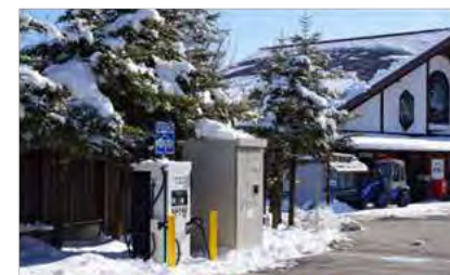
村内のEV充電設備 出所：白馬EVクラブ
