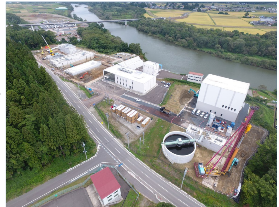
新北上浄水場の全景
