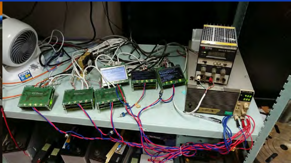
制御コントローラ 安定化電源
