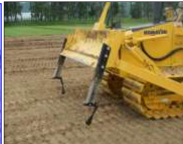
弾丸暗渠施設 (排水性向上)
