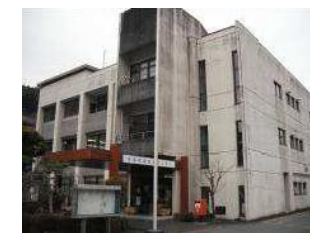
老朽化した公共施設
