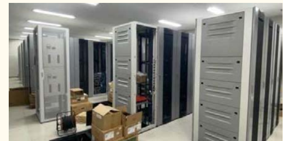
NW機器、サーバ搭載ラック
