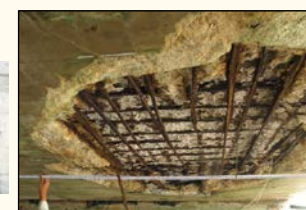
<床版鉄筋露出>
