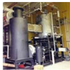
バイオマス ボイラ
