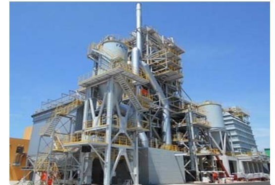
江津バイオマス発電所
