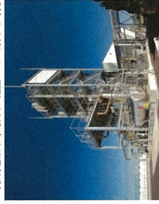
石炭火力発電所に設置された二酸化炭素分離回収設備
