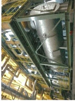
福島市・堀河町終末処理場 下水泥仮設減容化施設
