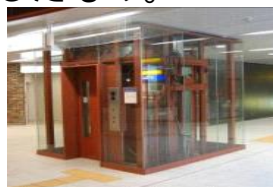
エレベーター
