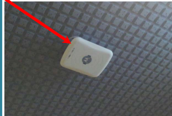
館内のWi-Fiアクセスポイント
