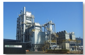
木質バイオマス発電所
