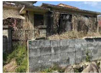
劣化が進み、改修などが困難となった空き家は、景観・治安の悪化や将来的な行政負担につながるリスクを有している
