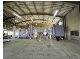
乾燥設備全景
