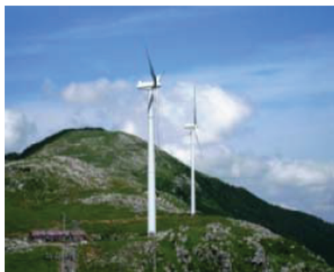
高原に設置された風車
