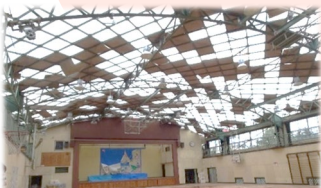
台風で屋根が消失した体育館
