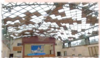
台風で屋根が消失した体育館
