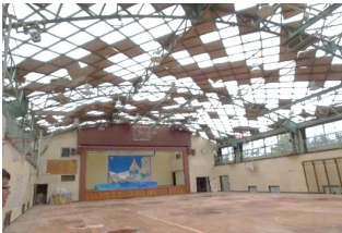
台風で屋根が消失した体育館
