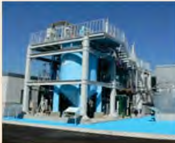
リン回収施設
