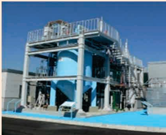
リン回収施設
