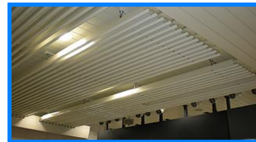
■天井輻射冷房
