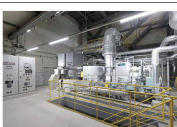
蒸気タービン発電
