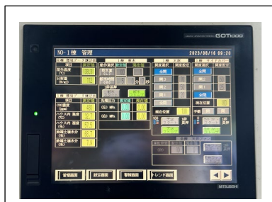
設備遠隔監視・制御システム
