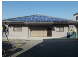
太陽光発電システム
