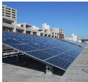
小学校の屋根に設置した太陽光発電設備
