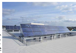
湖畔小学校に設置した太陽光パネル 10kW
