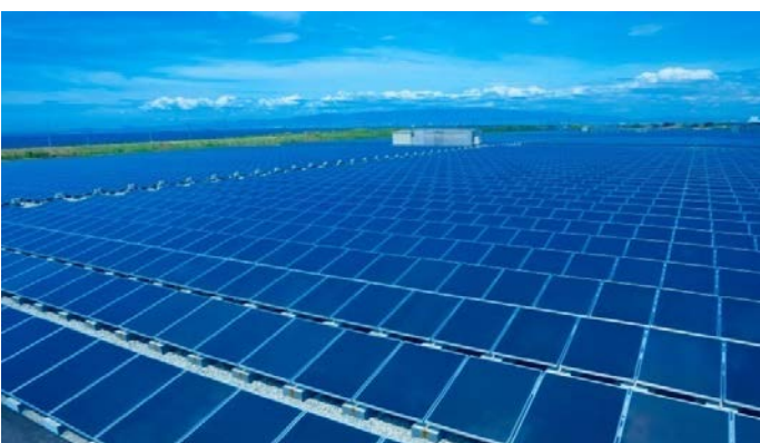
堺太陽光発電所（10MW）
