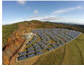
かえるかわうち・メガソーラー発電所
