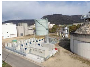
バイオマス発電設備
