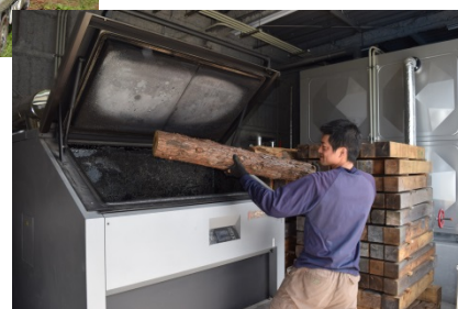
↓木質（薪）バイオマスボイラー
