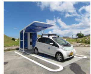
島内の電気自動車及び急速充電設備
