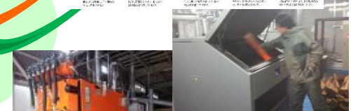
温泉施設新ボイラー
