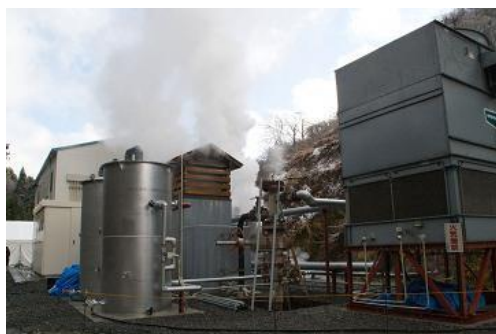
バイナリー地熱発電実証施設(十日町市)
