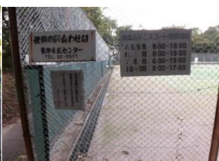
さび等の目立つ施設
