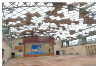
台風で屋根が消失した体育館
