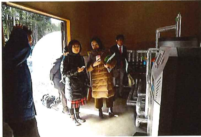
木質バイオマスのボイラー（手前）。小型でユーザビリティも高い
