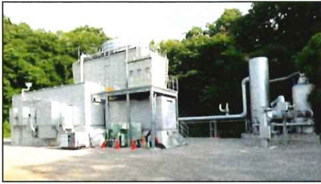
地域住民による合同会社が運営するわいた地熱発電所(2014年稼働)
