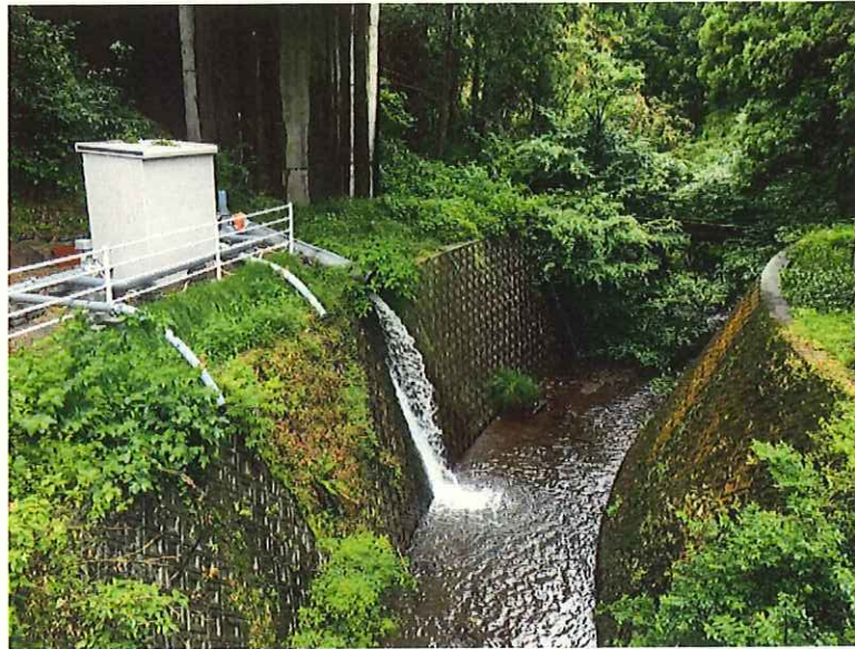
マイクロ水力発電実証実験施設(御殿場市二子)
