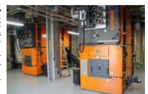
→ 木質バイオマスボイラー
