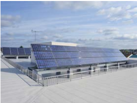
湖畔小学校に設置した 太陽光パネル10kW
