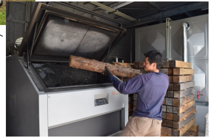
木質（薪）バイオマスボイラー
