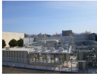
松山市中央浄化センター 消化ガス発電設備
