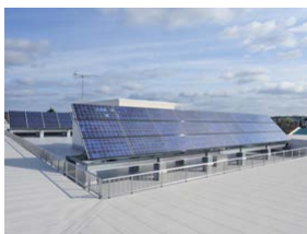
湖畔小学校に設置した太陽光パネル10kW
