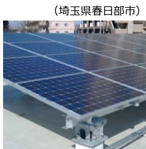
粕壁小学校屋上に設置した太陽光電池（防災対応型）
