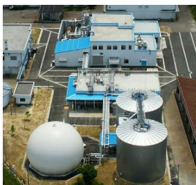
生ごみバイオガス発電センター
