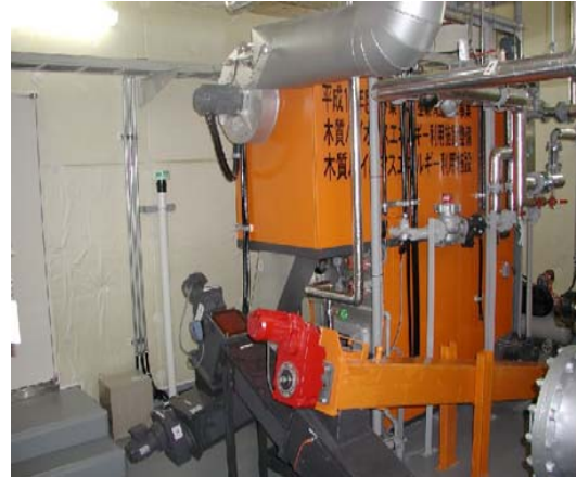
木質バイオマスボイラー
