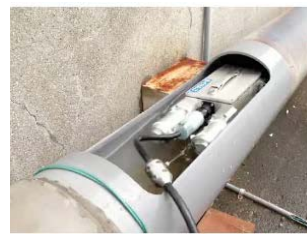
上下水管、プラント配管
