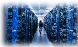
データセンター
