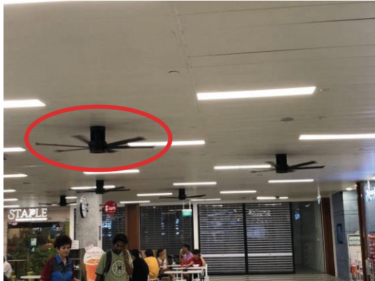
気温・湿度センサーと連携して制御が自動化された屋内ファン
