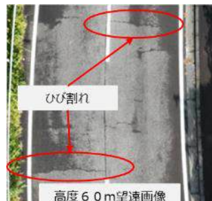
ひび割れ結果検証
