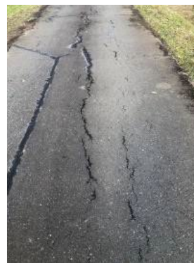
正しく検索できた画像の例 (道路の破損)
